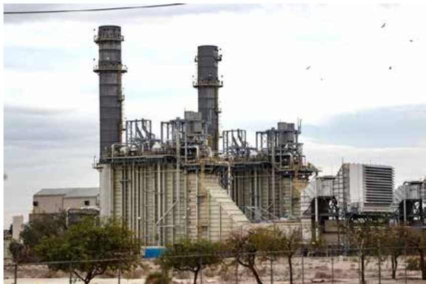
Central Geotermoelectrica Cerro Prieto en el Valle de Mexicali perteneciente a la red de producción eléctrica nacional de la Comisión Federal de Electricidad. Foto Cuartoscuro / archivo
